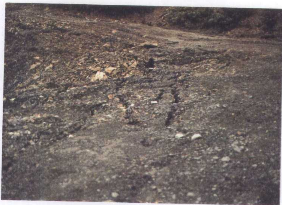
FOTO nº 7.1. - DEFINICION DE GRIETAS, INESTABILIDAD DE LA ESTRUCTURA
